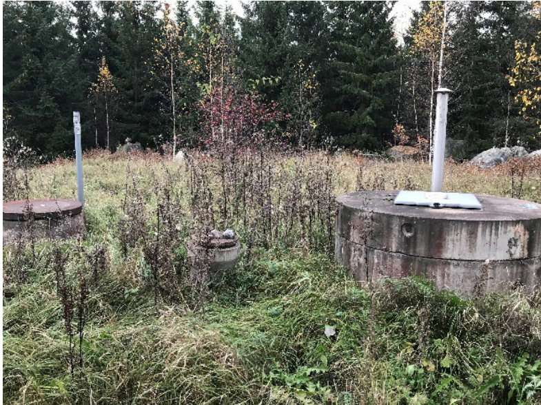
Foto: Västerås stad. Svavelvätebrunnar.
